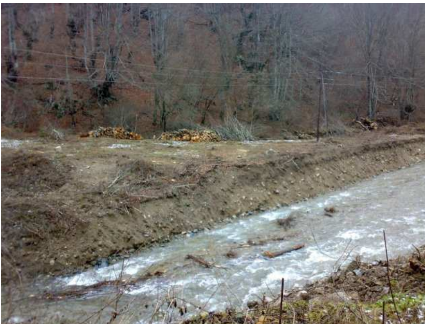
Почистване руслото на р. Елешница вследствие на поройни дъждове м. октомври 2009г.
